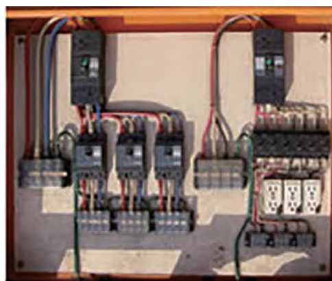
100V (75A) 200V (100A) 共用配電盤
